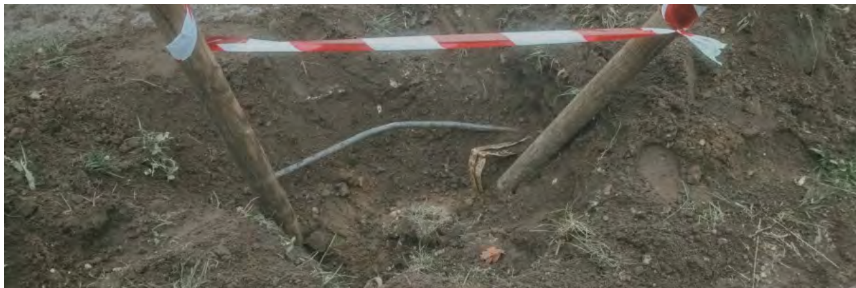
27. fotó: A közvilágítás kábel sérülése faültetése során
