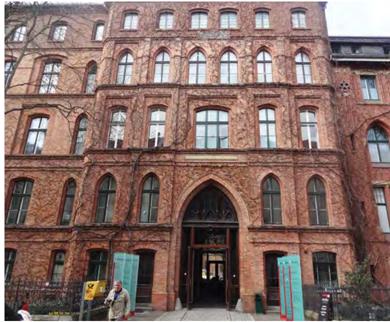
36. ábra A teljes homlokzatot befutó, több évtizedes vadszőlő alatt sértetlen a homlokzat (Berlin)
