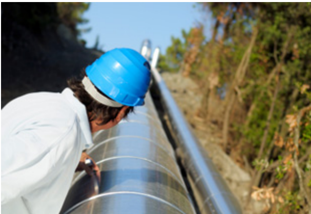
Távfűtő gerincvezeték (Forrás: estar)
