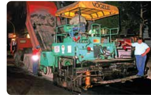
96. kép Vögele finiser
